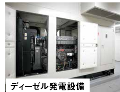
ディーゼル発電設備
