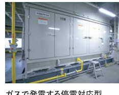
ガスで発電する停電対応型CGS設備
